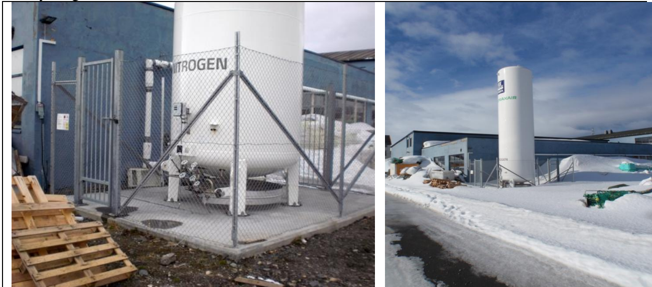
Foto som viser eksisterende nitrogengastank.
